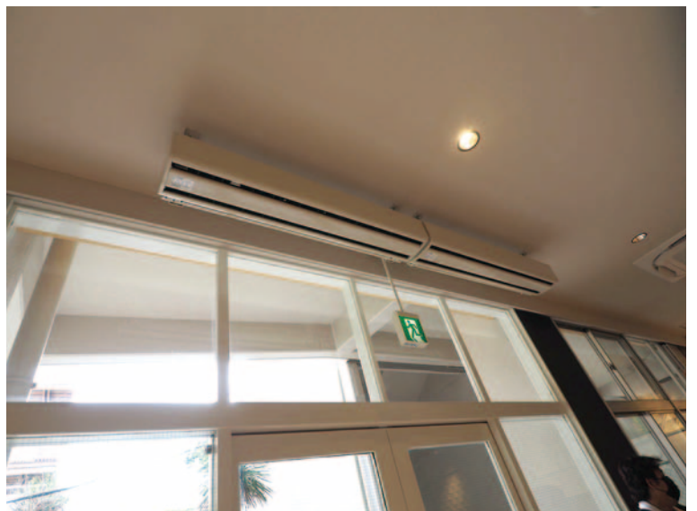
入口天井のエアカーテン
